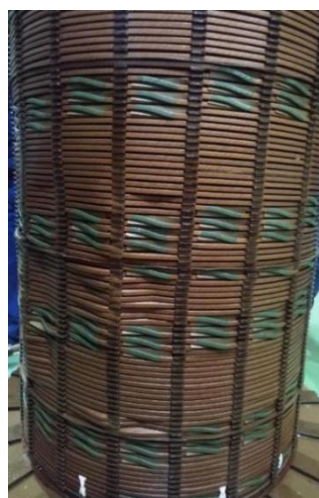
图 E.3 C 相中压绕组轻微变形
